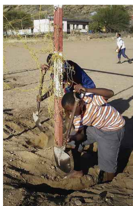
Buddeln, graben, schaufeln: Viele namibische Sportanlagen müssen saniert werden.
